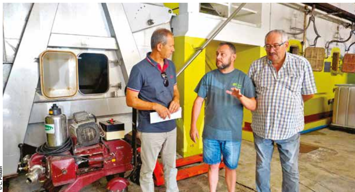
La coopérative a fait l'acquisition de pressoirs Pera membranaires inertés à cage fermée. « Dès que la vendange entre en cave et jusqu'à son conditionnement, nous cherchons à la protéger de l'oxygène, pour préserver la couleur et les arômes » explique Olivier Rambert à Christian Mounier, conseiller départemental, venu visiter la structure début juillet. À droite, le précédent directeur de la cave, Albert Blanc.
